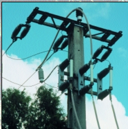
Madárvédelmi szempontból biztonságos transzformátoroszlop, a csupasz vezetékek a keresztartó kar síkja alá kerültek, a felső átvezetésű vezeték burkolt
