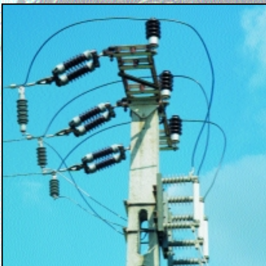
Madárvédelmi szempontból biztonságosra átalakított transzformátoroszlop, az átbukó vezetékek burkoltak
