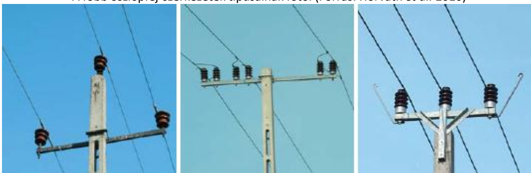
Tartóoszlopok: háromszög vezetőelrendezés (ez a leggyakoribb szerkezet) (1); egysíkú vezetőelrendezés kettős felfüggesztéssel (2); egysíkú szűkített vezetőelrendezés leesésgátlóval (3).
